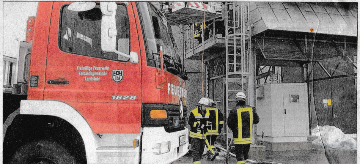
In einer Filteranlage der Gasverdichterstation Mittelbrunn brach gestern Nachmittag ein Feuer aus. Dabei entstand möglicherweise ein Sachschaden, der in die Hunderttausende gehen könnte.
